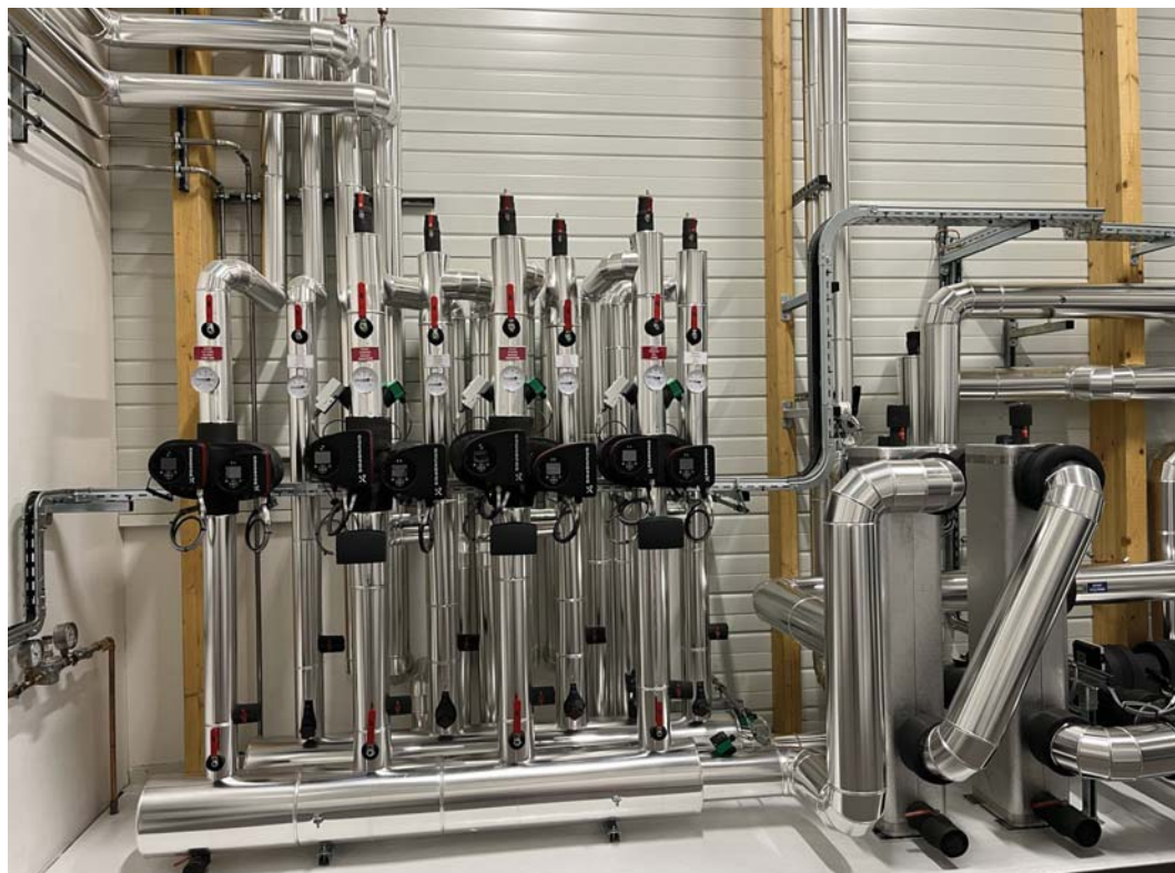
Départs chaufferie vers les émetteurs, plafonds rayonnants réversibles intégrés sous des plaques de plâtre BA13, et planchers chauffants hydrauliques pour le complément de chauffage dans les espaces spécifiques.
